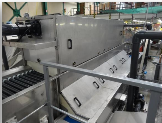
Tunnel de douchage
