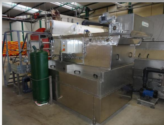
Bac chauffage et de retraitement de l'eau
