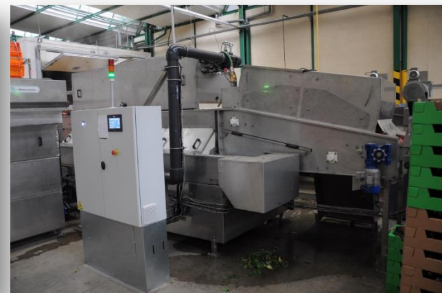
Tunnel de séchage
